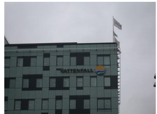
Lovpliktiga åtgärder – fasadskylt och flaggborg
