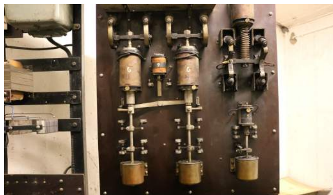
Ursprunglig teknisk utrustning i fläktrum.
