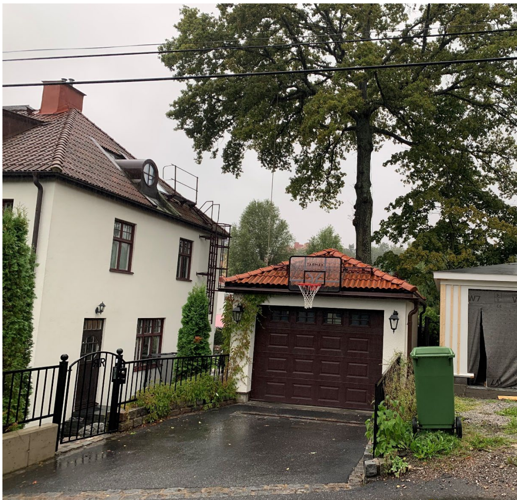
Fotot visar den genomförda garagebyggnadens snörasskydd och stuprännor på taket samt markrännor och brunn på garageuppfarten. Foto från 2021.
