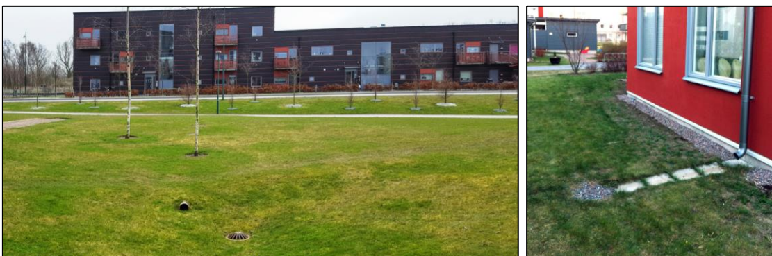
Figur 6-1. T.v. Dagvattenhantering i grönyta med kupolbrunn för bräddning av överskottsvatten (Haninge kommun, n.d.). I stället för att dagvatten leds ut via ledning, som i fotografiet, kan dagvattnet ledas ut över grönytan via ränndalar i exempelvis gatsten eller grus, vilket underlättar infiltrationen och minskar risken för erosion. T.h. Ett alternativ för att avleda takvatten till en grönyta för infiltration, där vattnet leds till en liten stenkista i grönytan (Stockholm Vatten och Avfall, 2022a).
