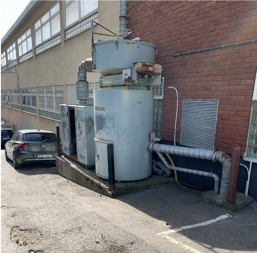
Figur 3. Tank för dammfiltrering. Foto taget 2020-04-08.
