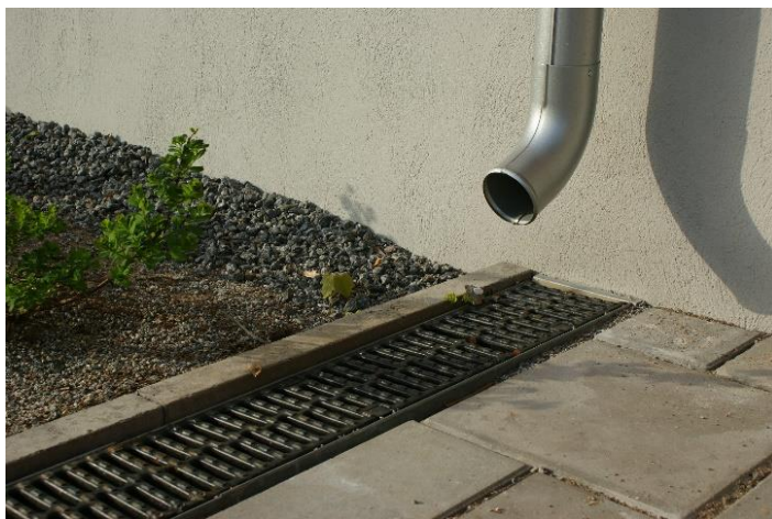
Figur 17 – Utkastare för avledning av dagvatten (Bild: Sweco).
